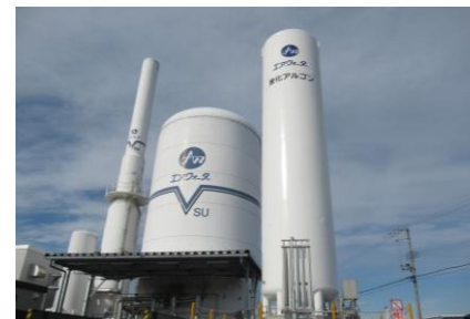
アルゴン貯槽タンク
