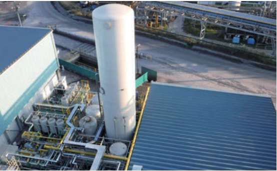
COURSE50 高炉ガス精製設備
