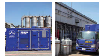
停電時に出動した移動電源車
