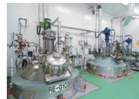
鹿島工場 GMP プラント
