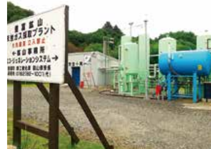
豊富町の天然ガス採取プラント
