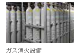
ガス消火設備
