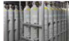
ガス消火設備
