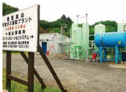
豊富町の天然ガス採取プラント
