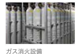
ガス消火設備
