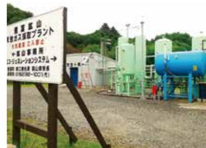
豊富町の天然ガス採取プラント
