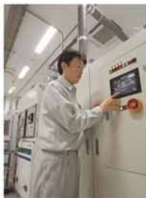
PFC回収・精製・再利用システム
