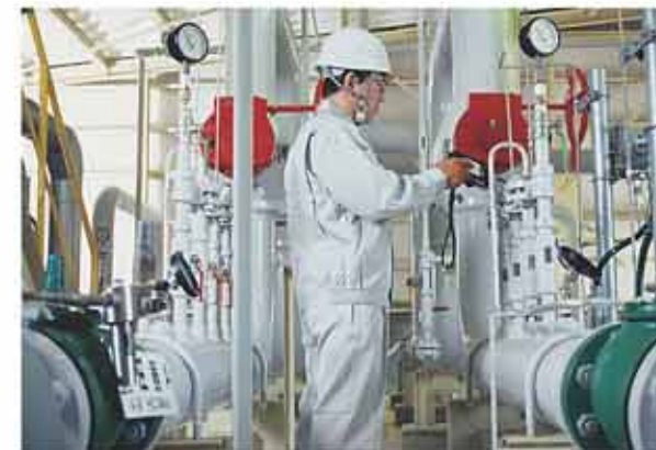
天然ガス供給設備
