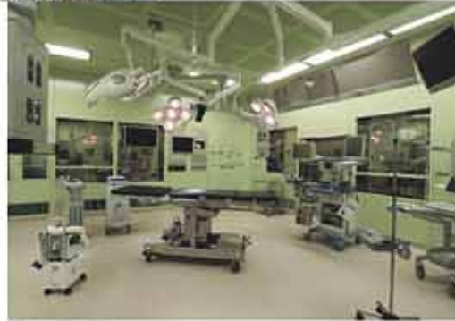
手術室関連設備
