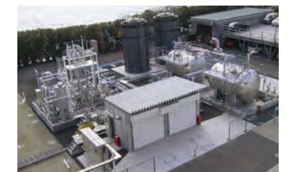
高純度アンモニア精製プラント
