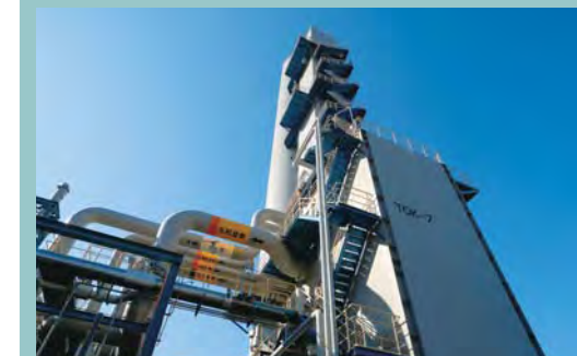
鹿島工場7号プラント
