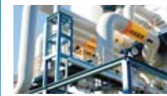
パイピングによるガス送給
