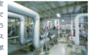
天然ガス供給センター
