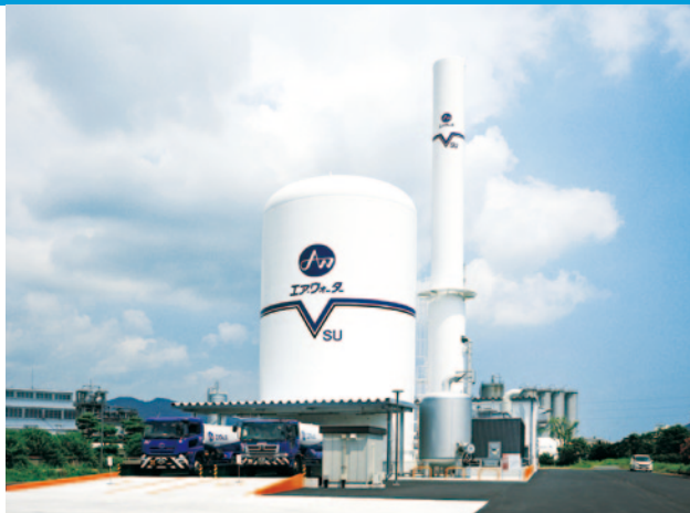
エア・ウォーターにとって11基目となる防府VSU。 地域分散型の産業ガス供給システムの構築を担っている。
