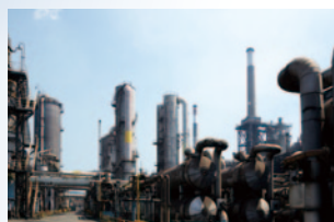
ガス精製プラント
