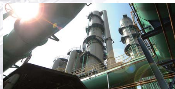
和歌山工場 ガス精製プラント
