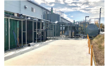
メタンガス発酵の実証プラント
