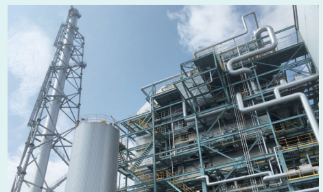
2021年1月に稼働を開始した赤穂第2バイオマス発電所
