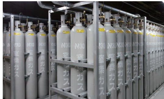
窒素ガス消火設備
