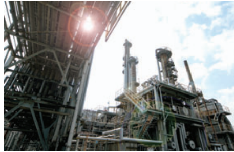
鹿島工場 タール蒸留プラント
