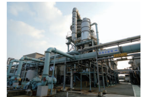
(株)日本海水 赤穂工場 製塩プラント
