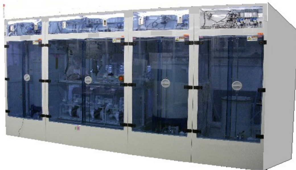
CMP スラリー調合・供給システム
