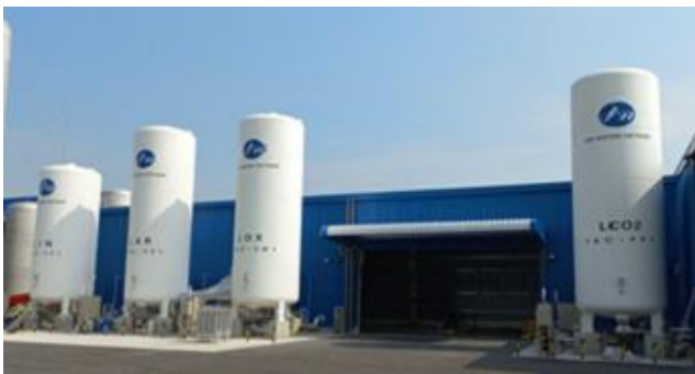
CE (低温液化ガス貯槽)
