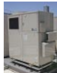
コージェネレーションシステム
