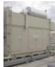
コージェネレーションシステム
