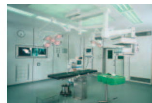
手術室関連設備
